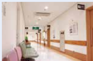
天井・壁・床を新しく貼り替え、明るくなった放射線室前廊下。
